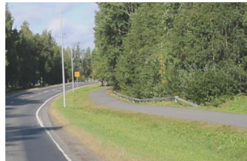
Kuva 38 Jalankulun ja pyöräliikenteen väylän sortumakohde
