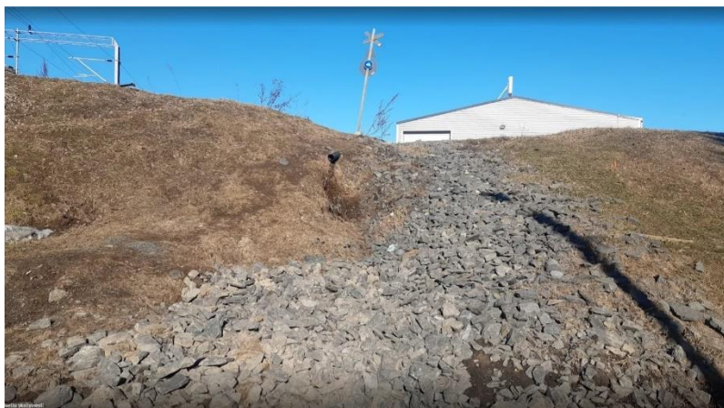
Kuva 37 Uitonpolun alikulun viereisen luiskan sortumakohta sekä hulevesien purkupuutken pää
