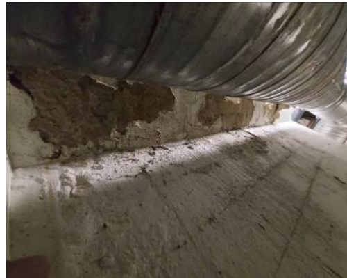
Kuva 46. Rapautumaa ison altaan seinän yläosassa
