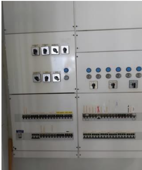
Kuva 114. Sähkökeskus K15 Valvomotilassa.
