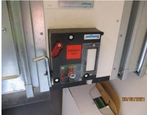
Kuva 64. Palopeltejä ei ole liitetty rakennusautomaatioon.
