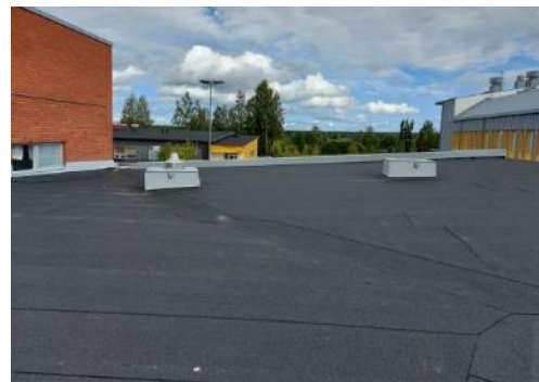
Kuva 125. Vesikatolla jiiri- ja kattokaivolämmityskaapelit saattaisivat olla tarpeelliset.
