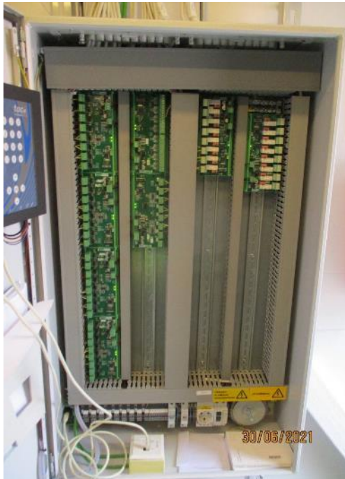
Kuva 82. Yleiskuva IV-konehuoneen valvomoalakeskuksesta.
