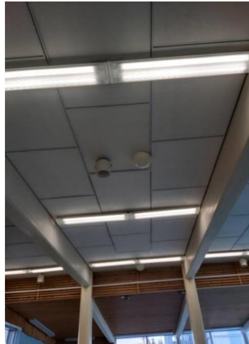
Kuva 121. Allastilan loisteputkivalaisimia. Valaisimiin vaihdettu LED-putket.
