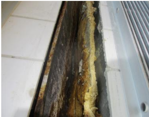
Kuva 94. Lasten- ja opetusaltaan tuloilmasäleiköt eivät ole enää toimintakuntoiset.
