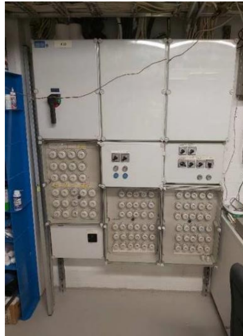
Kuva 115. Sähkökeskus K10, Kellarikerroksessa.
