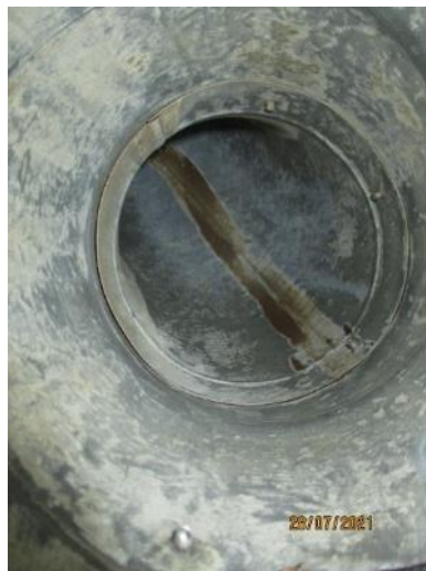
Kuva 102. Naisten pesuhuonetilan tuloilmapäätelaitteen kytkentäkanava. Kanavapinnoilla hapettumia ja pinnittynyttä likaa.
