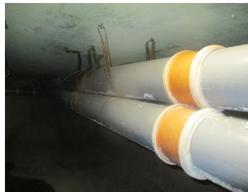
Kuva 93. Tasausallastilassa kulkevia muovisia tuloilmakanavia. Kannakoinnit on toteutettu puutteellisesti.
