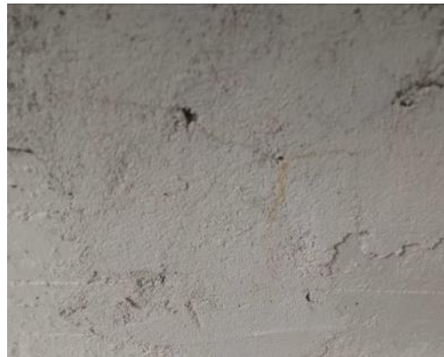
Kuva 40. Laastipaikkauksissa on halkeamia, joissa näkyy mahdollisesti ruostevalumaa
