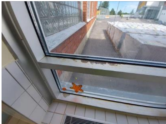
Kuva 14. Klooripitoinen kosteus on aiheuttanut ikkunankarmiin korroosiovaurioita
