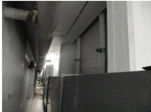
Kuva 89. Altaiden alatilassa kulkee tuloilman runkokanava (suorakaidekanava), mistä on haaroitettu kytkentäkanavat ikkunapenkkien tuloilmasäleiköille.
