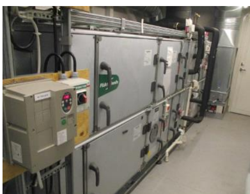
Kuva 72. Yleiskuva ilmanvaihtokoneesta TK02. IV-kone on sijoitettu vesikatolla olevaan IV-konehuoneeseen.
