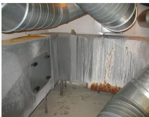
Kuva 86. Altaiden alatilassa olevat kanavat ovat paikoin pahasti korroosion vaurioittamia.
