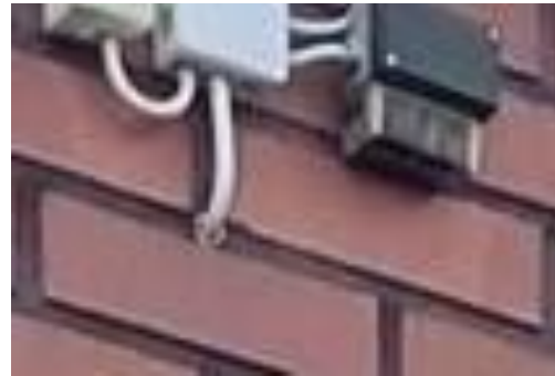
Kuva 117. Ulkoseinällä johtoläpiviennit tulisi tiivistää ja ylimääräiset käytöstä poistetut termostaatit poistaa.
