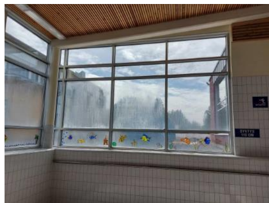
Kuva 13. Ikkunapinnassa on kalkkihärmettä
