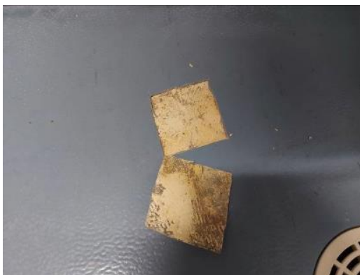
Kuva 22. Siivoushuoneen rakenneavaus, suhteellinen kosteus oli koholla ja matto irti alustasta
