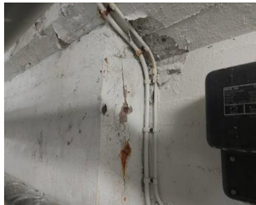
Kuva 42. Teräskorroosion aiheuttamaa halkeamaa
