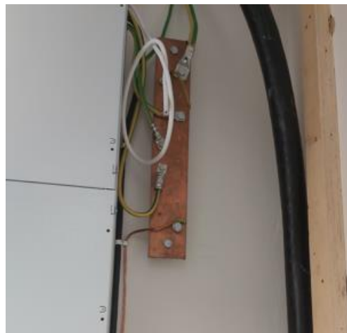
Kuva 113. Päämaadoituskisko ja syöttökaapeli.
