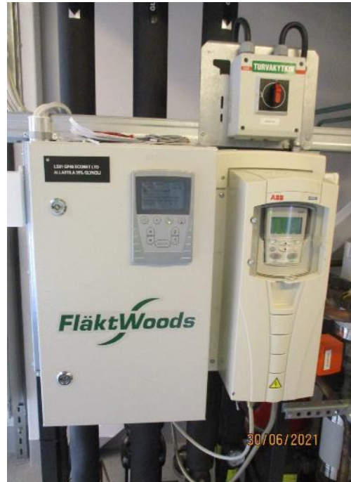
Kuva 83. IV-koneiden Econet-järjestelmät on varustettu omilla laitevalmistajan toimittamilla säätöyksiköillä.
