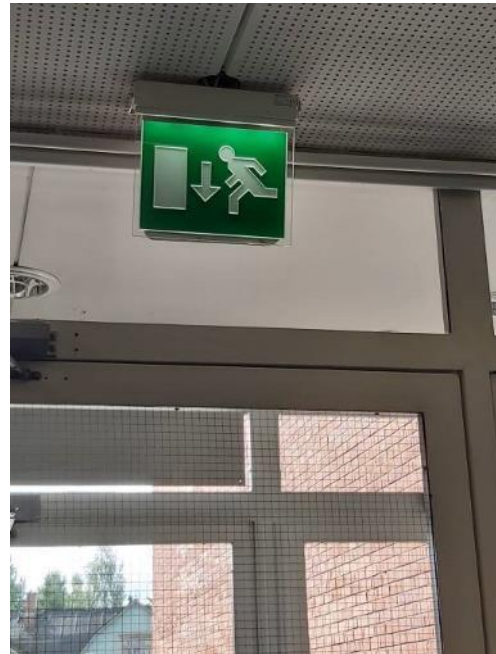
Kuva 127. Poistumistievalaisin pääsisäänkäynnin edustalla.
