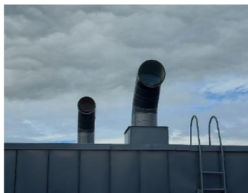
Kuva 71. TK01 ja TK02 jäteilmapiiput on toteutettu suunnitelmien mukaisesti. Toteutus ratkaisu mahdollistaa lumen ja veden ajautumisen jäteilmakanavaan ja sitä kautta IV-koneeseen.
