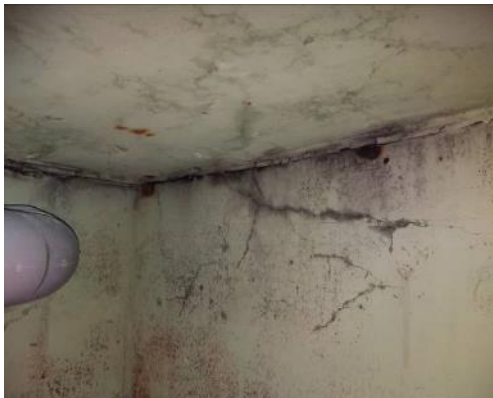
Kuva 51. Verkkohalkeilua tasausaltaan katossa ja seinässä. Seinähalkeamissa on merkkejä mahdollisesta ilmavuodoista
