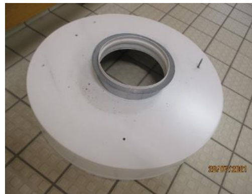
Kuva 99. Puku- ja pesuhuonetiloissa on käytetty tuloilmalaitteina Swegon Eagle tuloilmasäleikköjä. Säleiköt on liitetty ilman painetasauslaatikoita suoraan kytkentäkanaviin.
