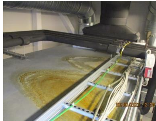
Kuva 75. IV-koneen TK2 päällä havaittiin pitkäaikaista altistumista ulkopuoliselle vedelle. Tutkimushetkellä vuotoa ei ollut tapahtunut, eikä vuodon lähdettä paikallistettu.
