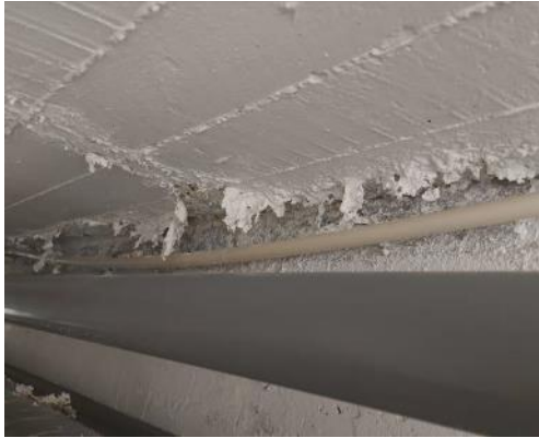
Kuva 43. Välipohjan ja altaan sauman vuodon aiheuttamaa pinnoitteen hilseilyä
