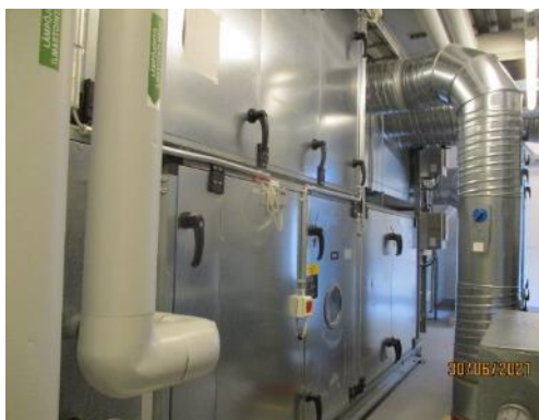
Kuva 68. Yleiskuva ilmanvaihtokoneesta TK01. IV-kone on sijoitettu vesikatolla olevaan IV-konehuoneeseen.
