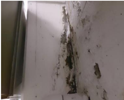
Kuva 49. Lasten altaiden puoleinen seinä on märkä
