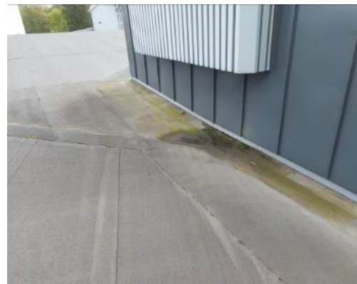
Kuva 61. IV- konehuoneen vierelle vesi lammituu ja paikassa on sammalkasvustoa
