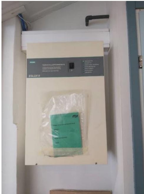
Kuva 126. Poistumistie- ja turvavalaistuskeskus.
