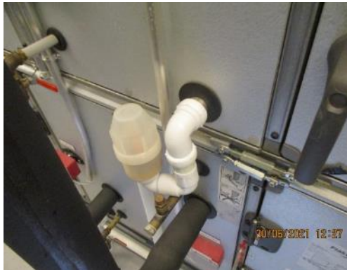
Kuva 74. IV-koneiden vedenpoistot on toteutettu oikeaoppisesti V32 viemäreillä ja pallovesilukoilla. V32 viemärit on johdettu lattiakavoihin.
