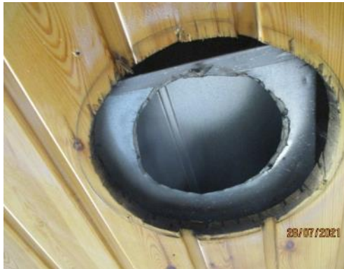
Kuva 100. Naisten pukuhuoneessa havaittiin puutteita tuloilmasäleikköjen asennuksessa. Liitos on epätiivis ja osa tuloilmasta puhalletaan alakattotilaan.
