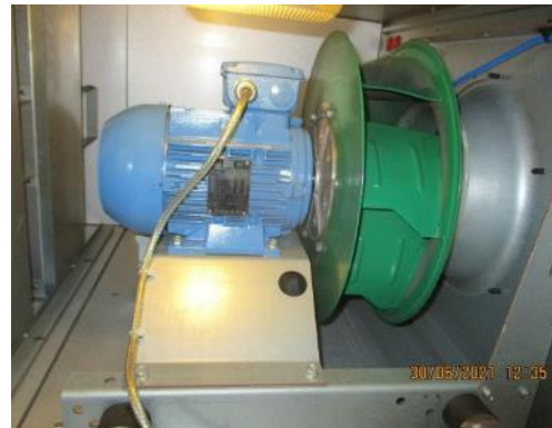
Kuva 77. IV-koneiden puhaltimet ovat suoravetoisia. Moottoreiden kaapeloinnit on toteutettu asianmukaisesti EMC-suojatuilla kaapeleilla.
