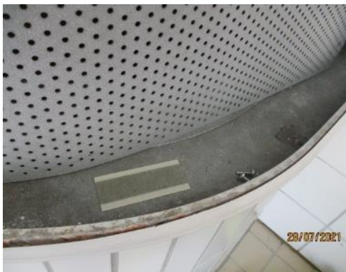
Kuva 98. Matalanopeustuloilmapäätelaitteen pinnat on kauttaaltaan hapettuneet ja puhdistettavuus on heikentynyt merkittävästi.
