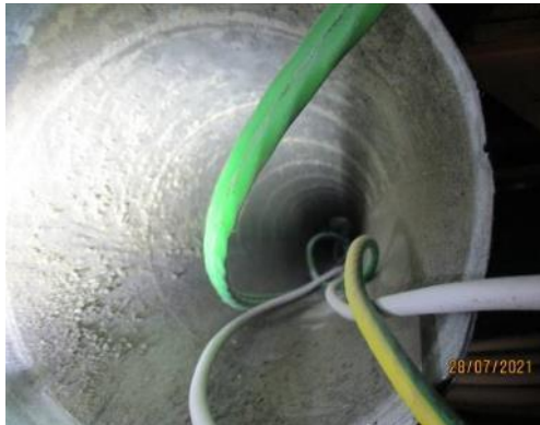
Kuva 116. Kaapeleita vedetty käytöstä poistettuun IV-kanavaan.
