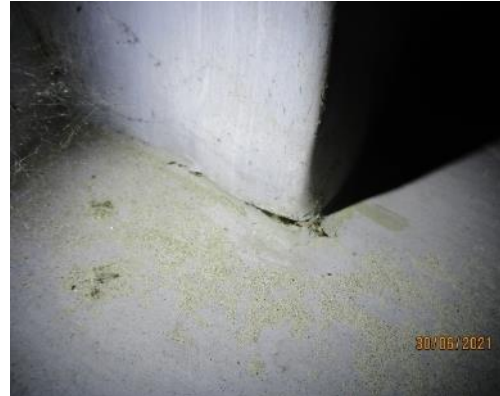
Kuva 65. Vesikaton IV-konehuoneen raitisilmakammiossa havaittiin ratkeamia lattiamaton saumoissa.
