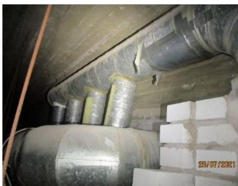
Kuva 104. Ennen v.2010 asennettuja IV-kanavointeja miesten pukuhuonetilassa. Kanavaliitoksissa havaittiin ratkeamia ja epätiivieyksiä.
