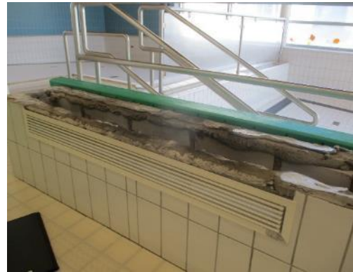
Kuva 95. Altaiden välissä oleva istuinpennkki toimii tuloilmasäleikkönä. Istuinosa on irrotettavissa, mutta pinnat ovat rakenneaineiset, eivätkä ne näin ollen täytä IV-järjestelmän osille asetettuja puhtausvaatimuksia.
