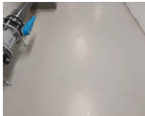
Kuva 7. Paikoin alapohjassa on hiushalkeamia
