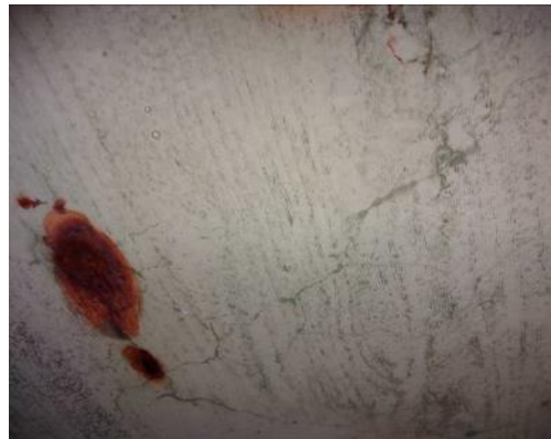
Kuva 52. Verkkohalkeilua ja ruostejälkiä tasausaltaan katossa.
