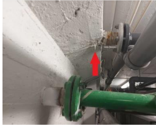
Kuva 44. Putken läpivienti on vuotanut. vuoto paikalla on kalkkivalumaa tai AKR-geeliä
