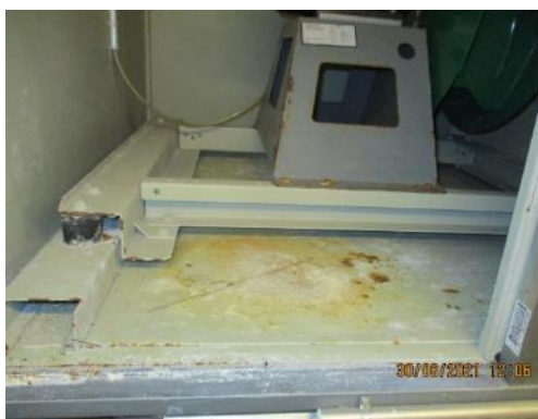
Kuva 70. TK01 PF01 kammiosta altistuu jäteilmapiipun kautta tulevalle kosteudelle ja kammiosta on huonokuntoinen.
