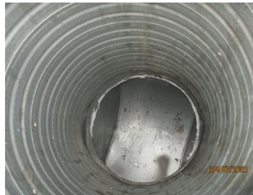
Kuva 97. Matalanopeustuloilmapäätelaitteen kytkentäkanavassa havaittiin pinttynyttä likaa ja hapettumia.
