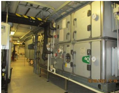
Kuva 76. Yleiskuva ilmanvaihdon koneesta TK03. IV-kone on sijoitettu kellarin tekniikkatilaan.
