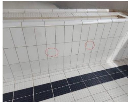
Kuva 34. Lasten altaan seinien laatoissa on halkeamia
