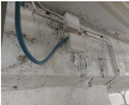
Kuva 41. Vuotojen aiheuttamaa maalin hilseilyä
