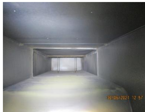
Kuva 67. Ilmanvaihtokoneen TK03 raitisilmakanava ja ulkoilmapiipun alaosa IV-koneen kammion kautta kuvattuna.
