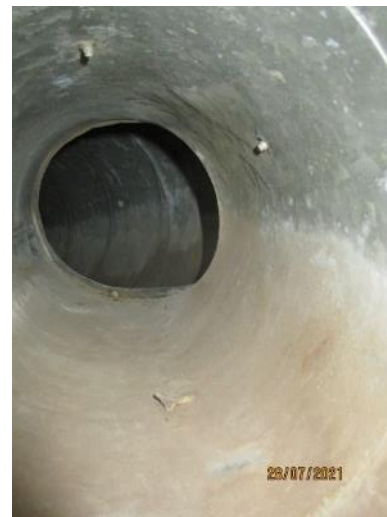
Kuva 103. Osa kanavoinneista todella heikossa kunnossa. Kanavapintojen puhdistettavuus on hapettumisesta johtuen heikentynyt merkittävästi.
