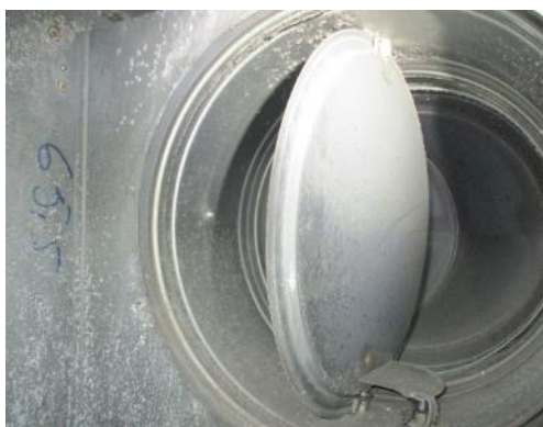
Kuva 84. Kellarissa oleva allastilan poistoilmakanavan palopelti. Palopelti käyttökänsä päässä. Kanavapinnoilla runsaasti hapettumia. Kanavaosat ovat ajalta ennen v. 2010 peruskorjausta.
