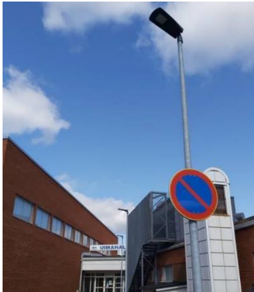
Kuva 109. LED-pylväsvalaisimia pääsisäänkäynnin edessä.
