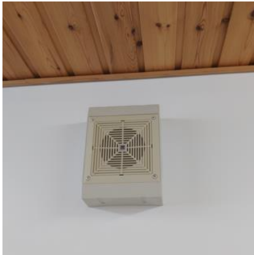
Kuva 128. Vanha kuulutus- ja yleisäänentoistojärjestelmän kaiutin pukuhuoneessa.
