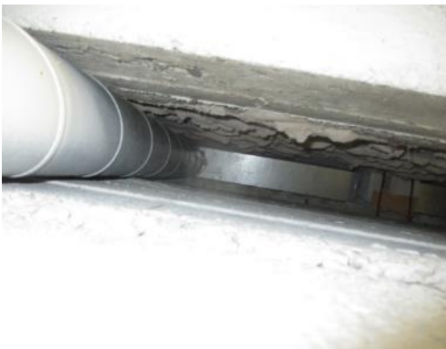
Kuva 90. Pääaltaan ikkunapenkkien tuloilmasäleiköt ovat nähtävissä alatilasta käsin. Kanavatila on ahdas.
