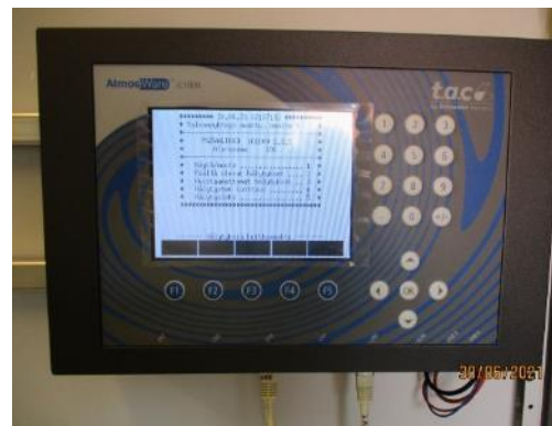
Kuva 81. Valvonta-alakeskus on varustettu Atmostech:n iC1000 yksikkösäätimillä.
