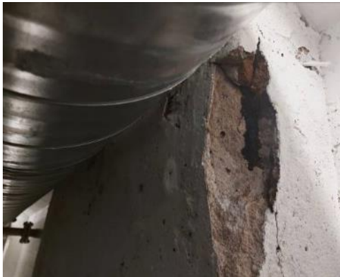
Kuva 47. Teräskorroosion aiheuttama lohkeama, joka on jo kertaalleen paikattu
