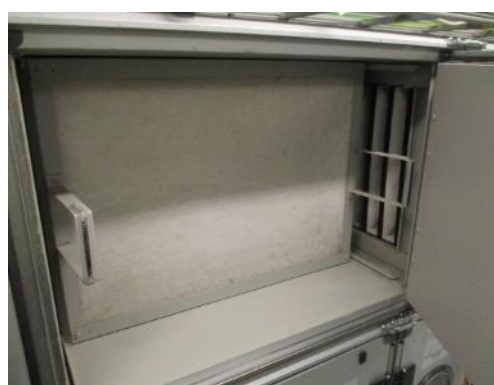
Kuva 73. IV-koneiden äänieristysmateriaalina on käytetty keinokuitua.
