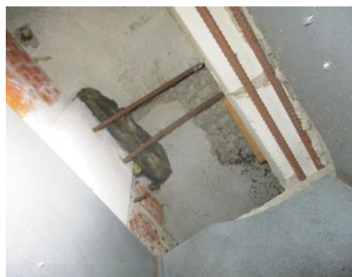
Kuva 85. Allastilan poistoilmakanan rakenne kellarista tulevan kytkentäkanavan kautta kuvattuna. Rakenne ei ole avattavissa eikä puhdistettavissa.
