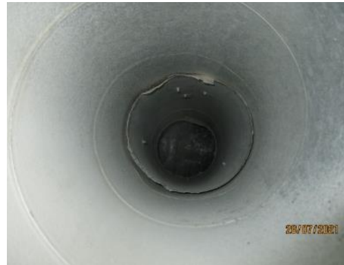
Kuva 101. Ennen v.2010 asennetuissa IV-kanavissa havaittiin useampia puutteellisia kanavaliitoksia. Liitokset eivät ole tiivisteellisiä tehdasosia.
