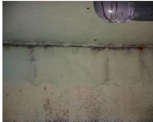
Kuva 50. Mahdollisesti alkalikiviaines reaktion aiheuttamaa verkkohalkeilua tasausaltaan seinässä
