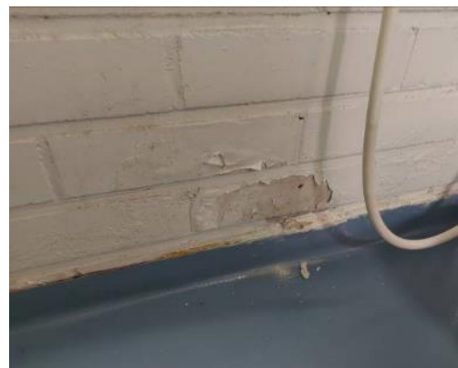
Kuva 19. Valvontatilan WC:n seinässä on kosteusvaurio
