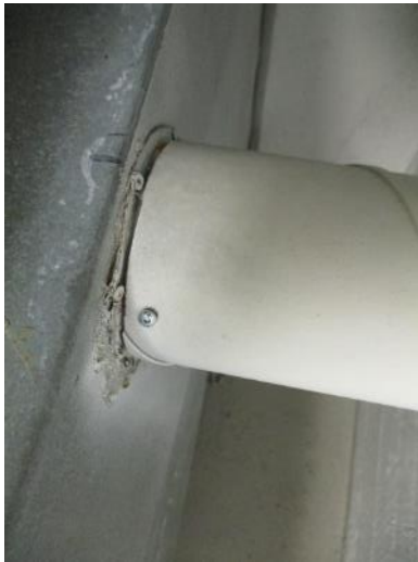
Kuva 88. Ennen v.2010 toteutetuissa kanavaliitoksissa havaittiin puutteita (liitokset vuotavat).
