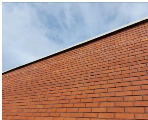
Kuva 10. Räystäiden puuttuminen lisää kosteusrasitusta julkisivujen yläosissa
