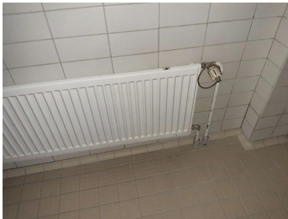
Kuva 3. Patteri ja patteriventtiili
