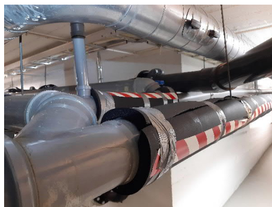
Kuva 10. Uusittua PVC-muoviviemäriä, kannakointi on paikoin puutteellista
