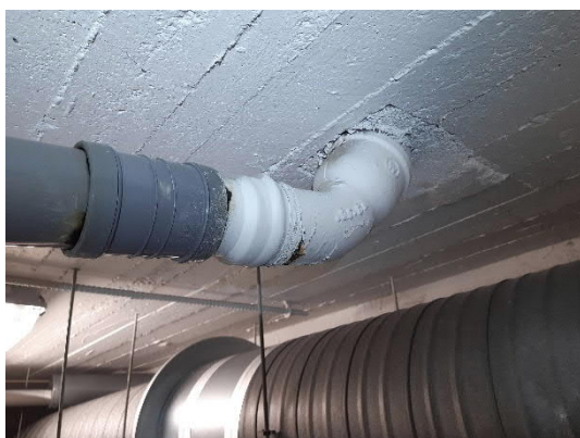
Kuva 9. Alkuperäistä valurautaviemäriä kellarin laitetilan katossa
