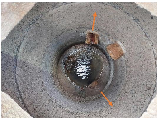
Kuva 11. Jätevesiviemärin tarkastuskaivo. Uimahallista tuleva pohjaviemäri (kuvaus JV2) lähtee kuvassa ylöspäin ja heikkokuntoinen pihaviemäri-osuus (kuvaus JV1) kuvassa alaviistoon.
