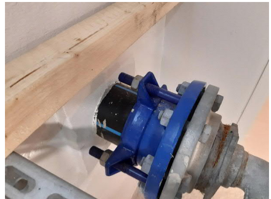
Kuva 8. Tonttivesijohto on muovia
