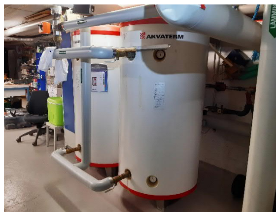
Kuva 2. Lämpimän käyttöveden puskurivaraajat
