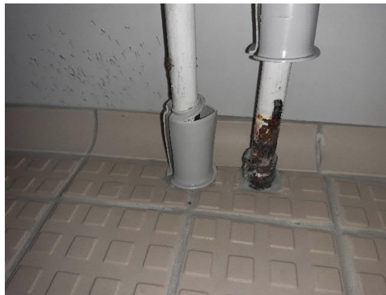
Kuva 4. Patteriputkien läpivientikohdassa ulkopuolista korroosiota
