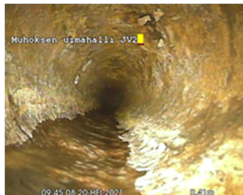
Kuva 12. Jätevesipohjaviemäri on suurelta osin alkuperäinen
